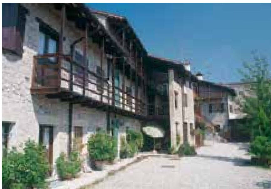
Casa Ponta a Zeglianutto di Treppo Grande e Borgo Miotti di Cassacco, restaurati con i fondi destinati al recupero dell'architettura rurale (art. 8 della L.R. 30/77)
