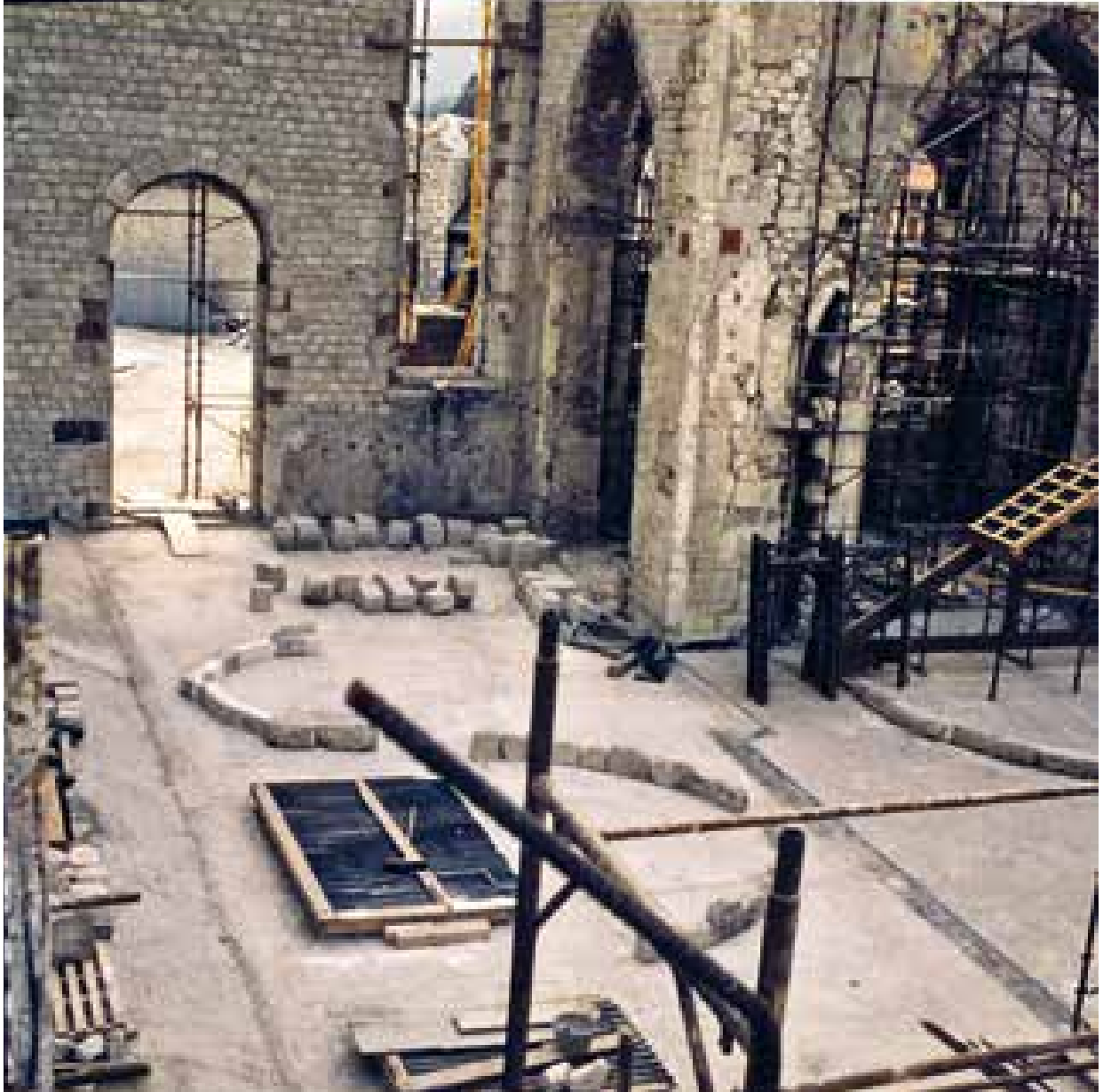
VENZONE. Ricostruzione delle volte delle absidi del duomo. Archivio Pieve di S. Andrea
