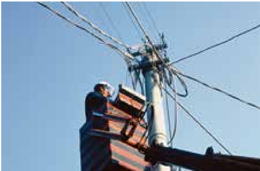
Interventi dell'ENEL di potenziamento delle linee elettriche di media tensione. La realizzazione di nuove opere di viabilità e di infrastrutturazione dei Comuni terremotati consentì l'ammodernamento delle reti di distribuzione elettrica. A. Moretti
